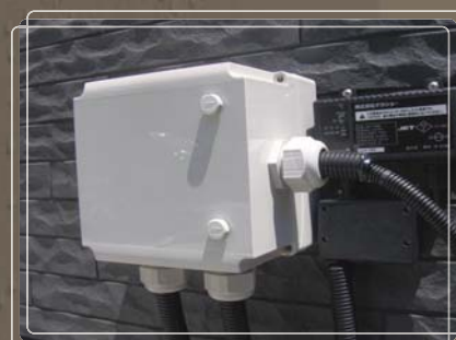
■駐車場ゲート開閉器中継ボックス
