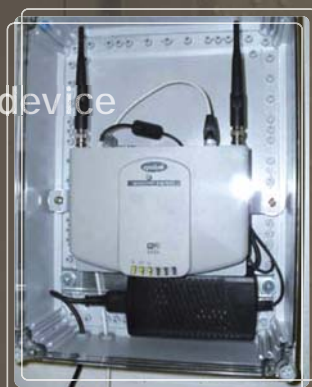
■無線アンテナ装置
